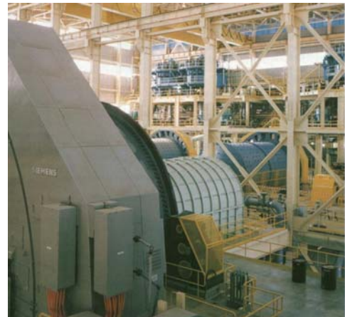
Figura 4.7: Interior de la planta, sector de molienda
